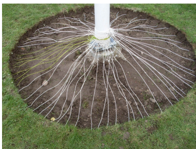
600m ledning fordelt på 60 radialer
